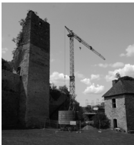
Début du chantier de restauration de la courtine entre la tour du fond et le logis nord
