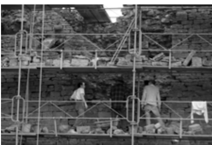
Chantier de la courtine, côté fossé Purge du parement sur environ 5m de hauteur
